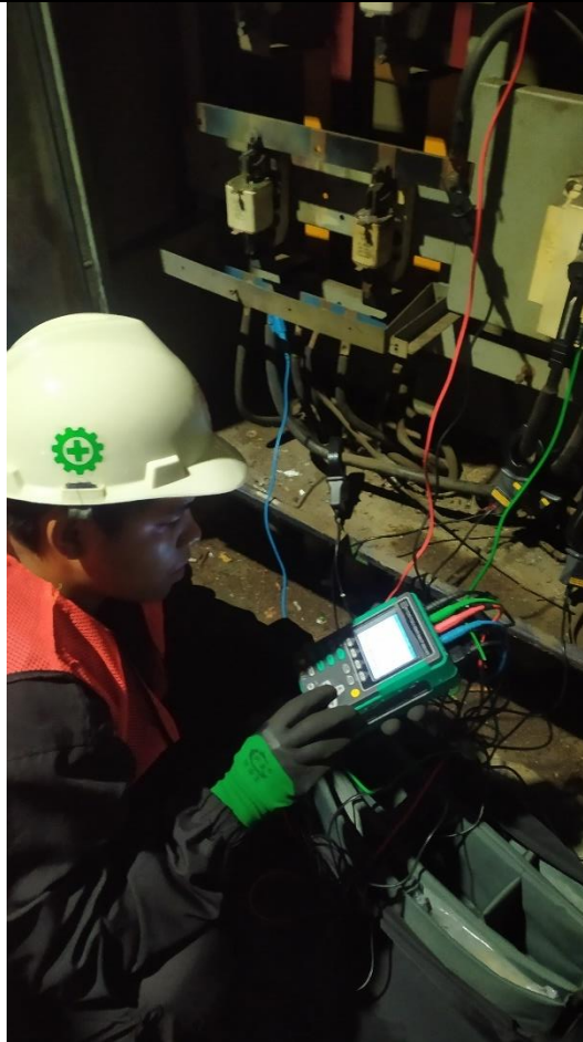
Pengukuran langsung pada trafo BBPL Pengukuran Malam Hari (04 Februari 2023)
