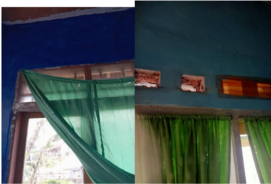
Kondisi ventilasi yang tertutup plastik
