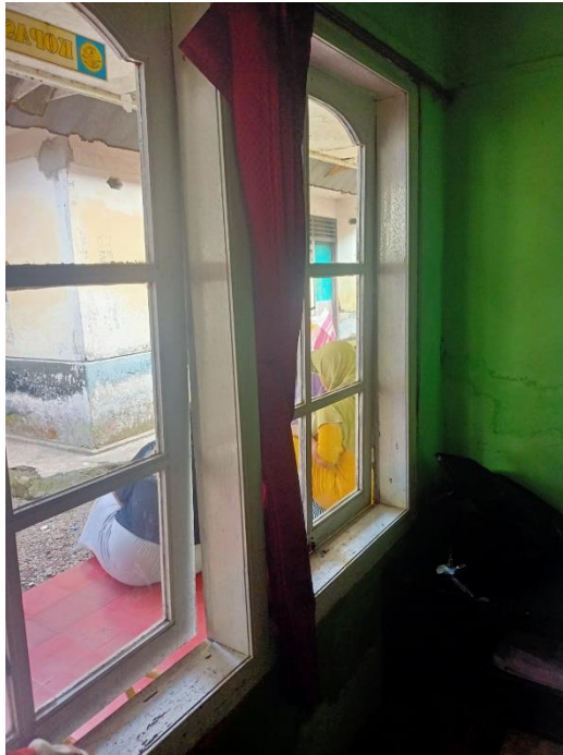
Kondisi jendela yang tidak dibuka
